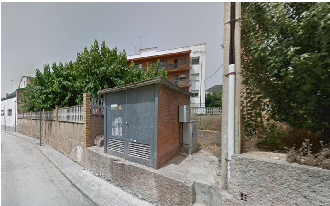
Carrer de la Garriga. Transformador
